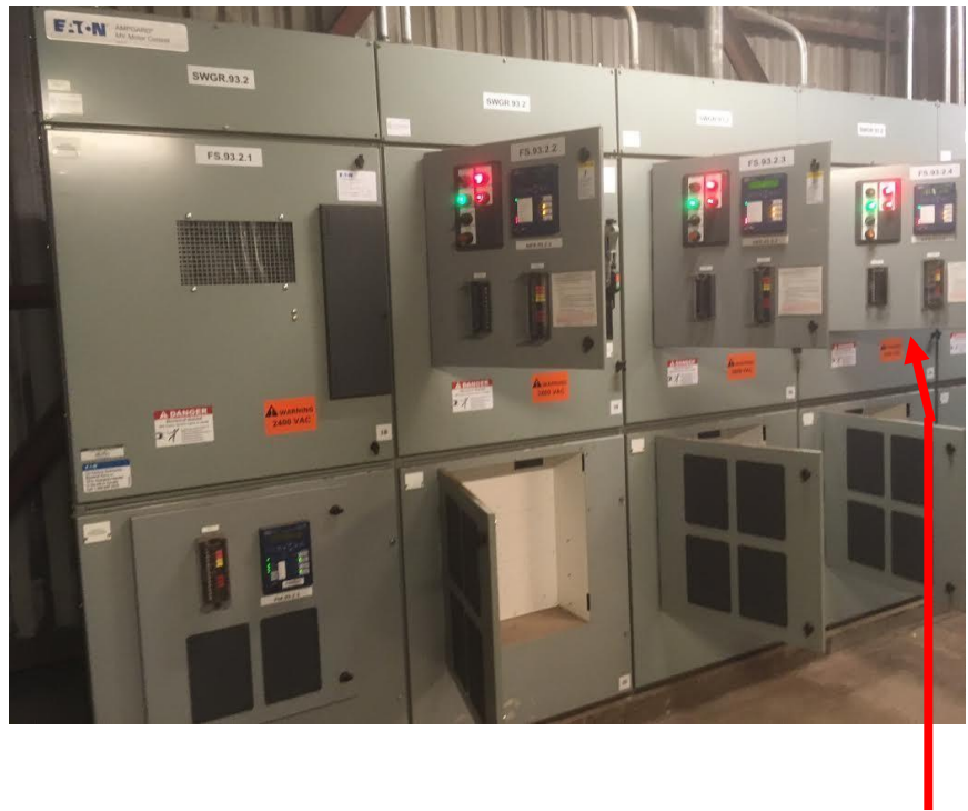
Descarga superficial detectada dentro de la puerta con sensor flexible ultrasónico. Se podía escuchar DP a través de los pequeños orificios en el panel en la parte superior izquierda del gabinete superior.
